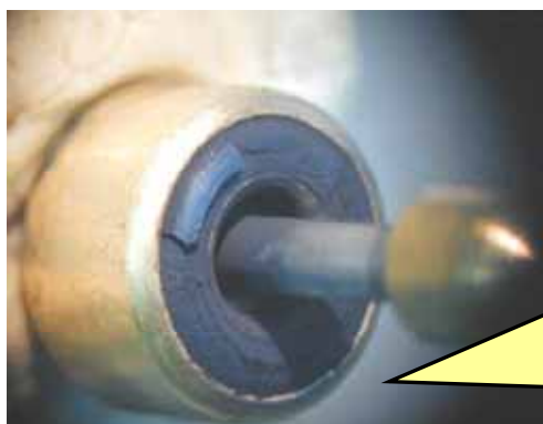
写真2 減圧弁の主弁シート部
